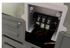
nouveau système de câblage
