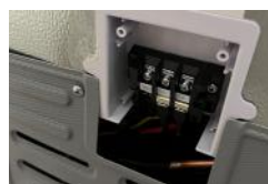
nouveau système de câblage
